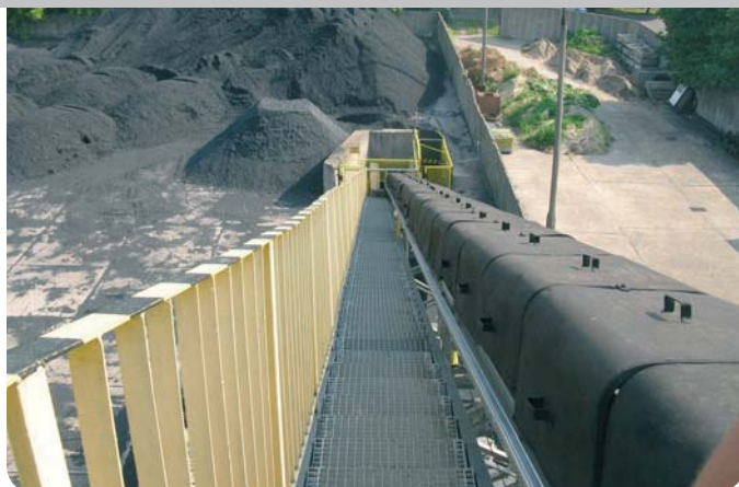
Fot.1. Transport węgla przenośnikiem skośnym ze składu węglowego Fig. 1. Slanting conveyor transporting coal from the storehouse
