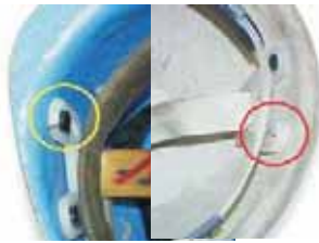
Fot. 9. Uszkodzenia zaczepów więźby Photo 9. Damage of the connecting elements of a cradle
